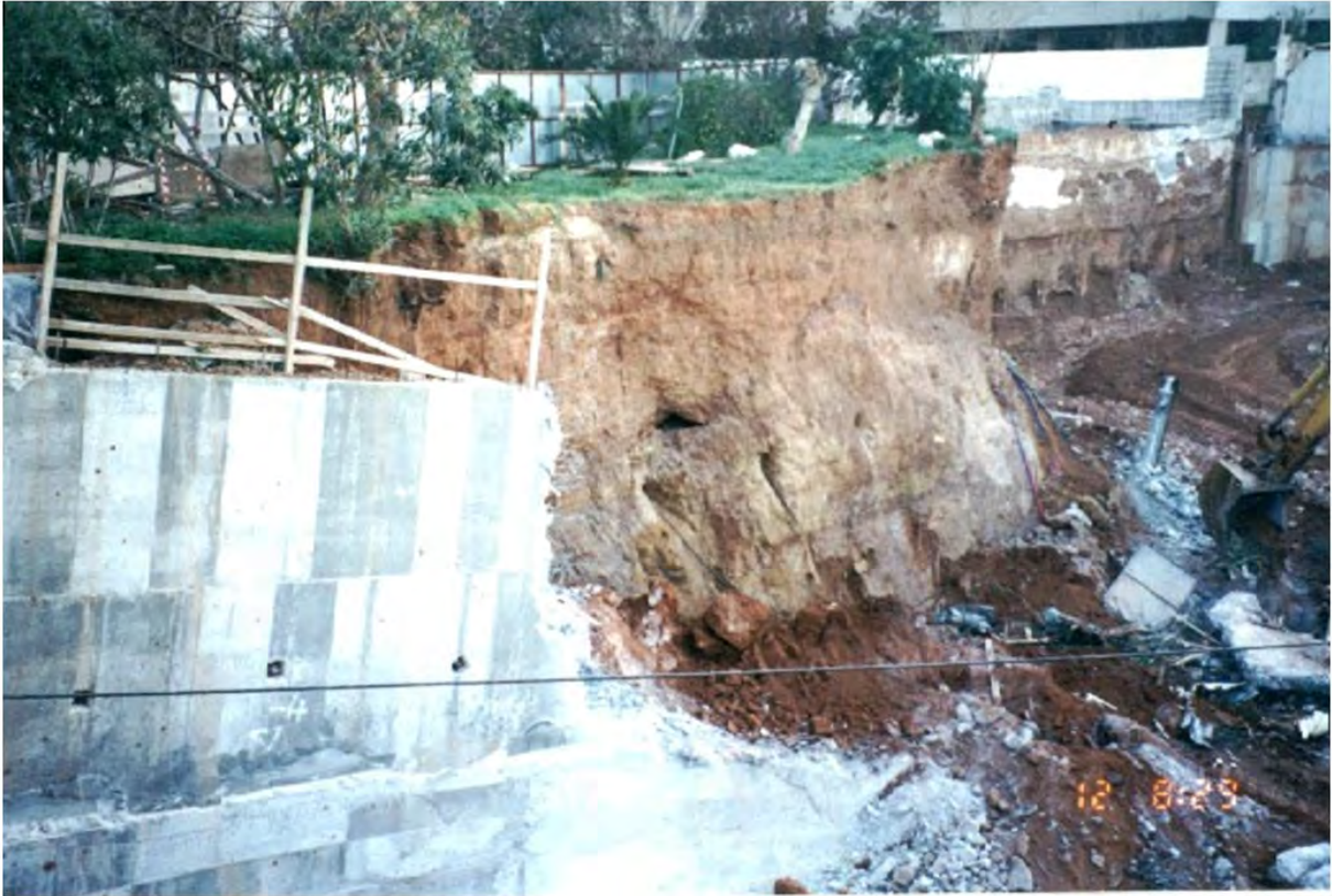
Αστοχία (κατάρρευση) τοίχου αντιστήριξης
